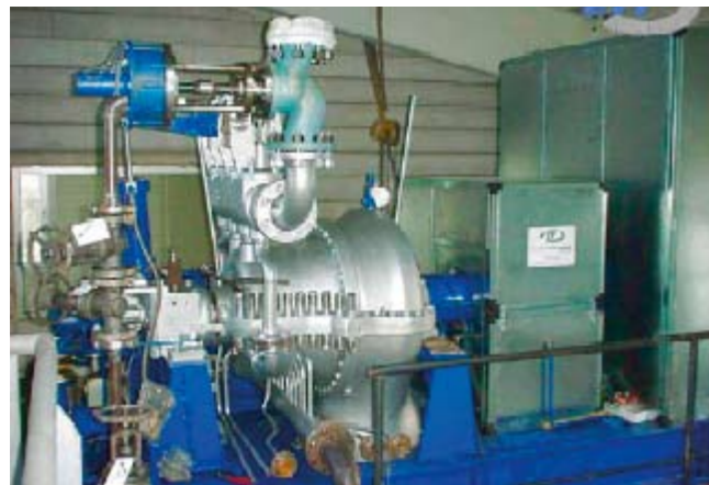
Flerstegs kondenserings/avtappningsturbin typ MT4 s7+G315 komplett med kondensör installerad i ett sågverk
